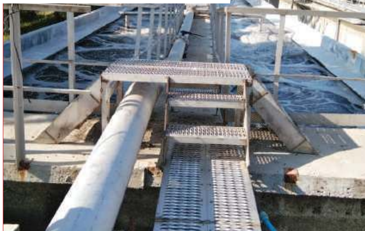
Miejska Oczyszczalnia Ścieków w Czerwonogradzie po realizacji projektu
