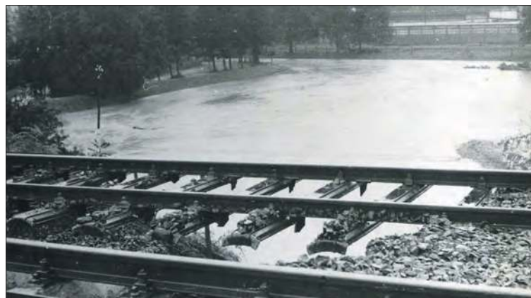
Przed kamiennym mostem kolejowym obok ul. Słowiczej utworzył się ogromny zalew. Zniszczenia w infrastrukturze kolejowej były tak znaczne, że zdecydowano się na budowę całkowicie nowego mostu, dbając przy okazji o zwiększenie prześwitu pod nim. (1997)
