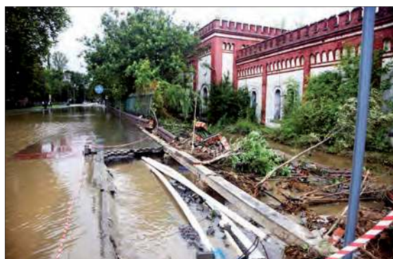
Zniszczone przez wodę ogrodzenie przy ul. Nyskiej
