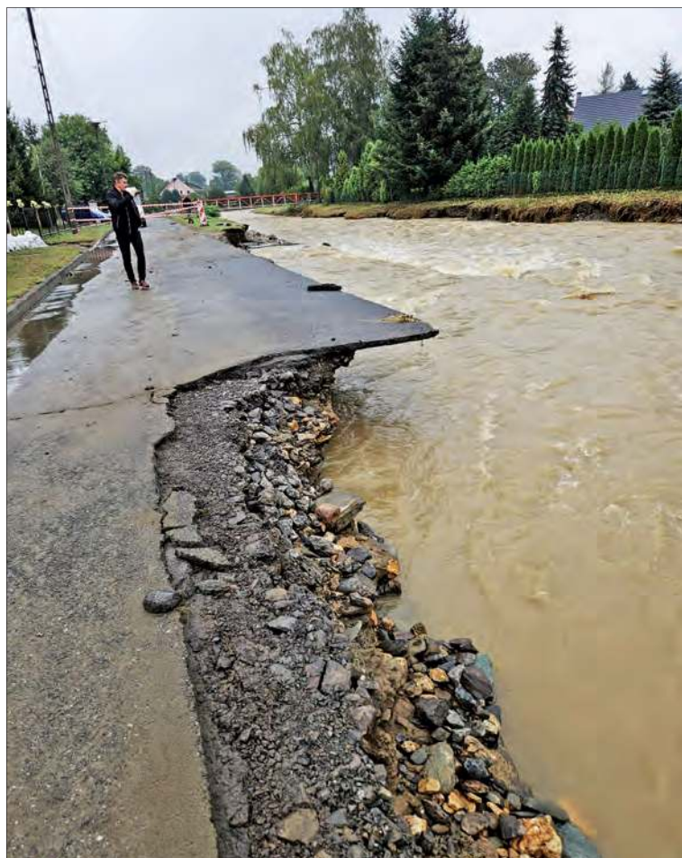
Zniszczona droga powiatowa w Moszczance
