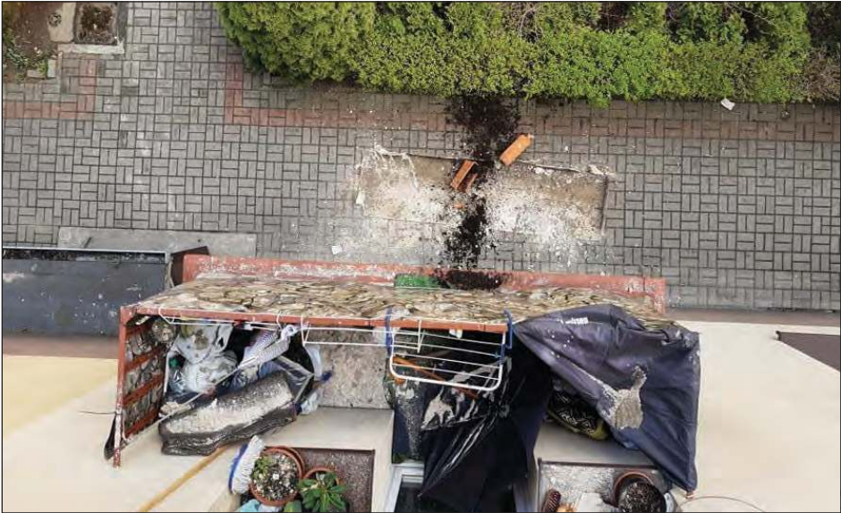
■ Szczęście w nieszczęściu, że w momencie oderwania się elewacji balkonu nikt nie przechodził chodnikiem wzdłuż bloku
