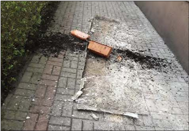
■ Z balkonu pana Jarosława oderwała się dolna elewacja. Na szczęście w tym czasie na chodniku nie było nikogo. W innym wypadku mogłoby dojść wręcz do tragedii
