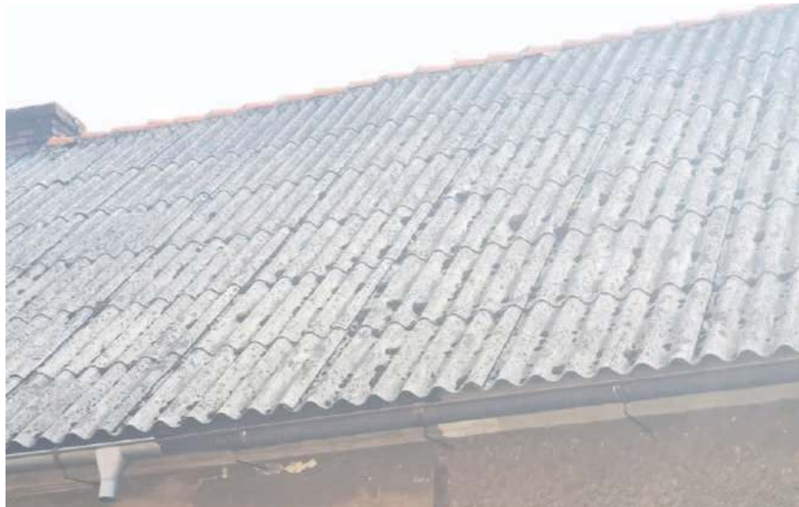
Na naszych dachach wciąż jeszcze można spotkać eternit, którego głównym składnikiem jest szkodliwy azbest
