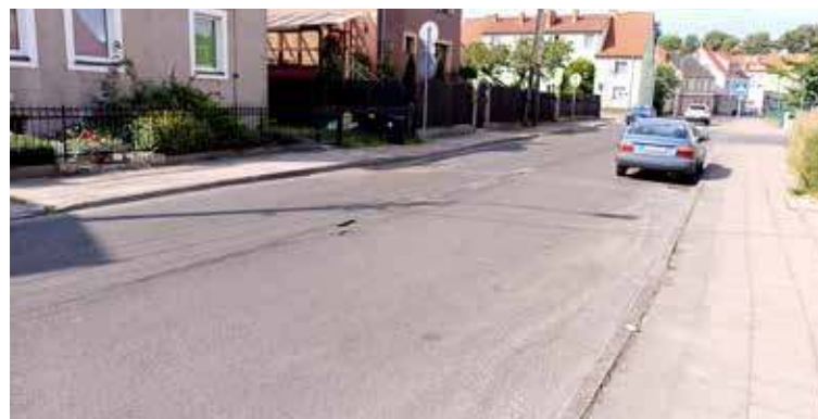
Nawierzchnię ulicy Konopnickiej znaczą liczne dziury
