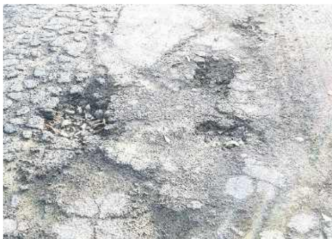
Nawierzchnia drogi do Piekar
