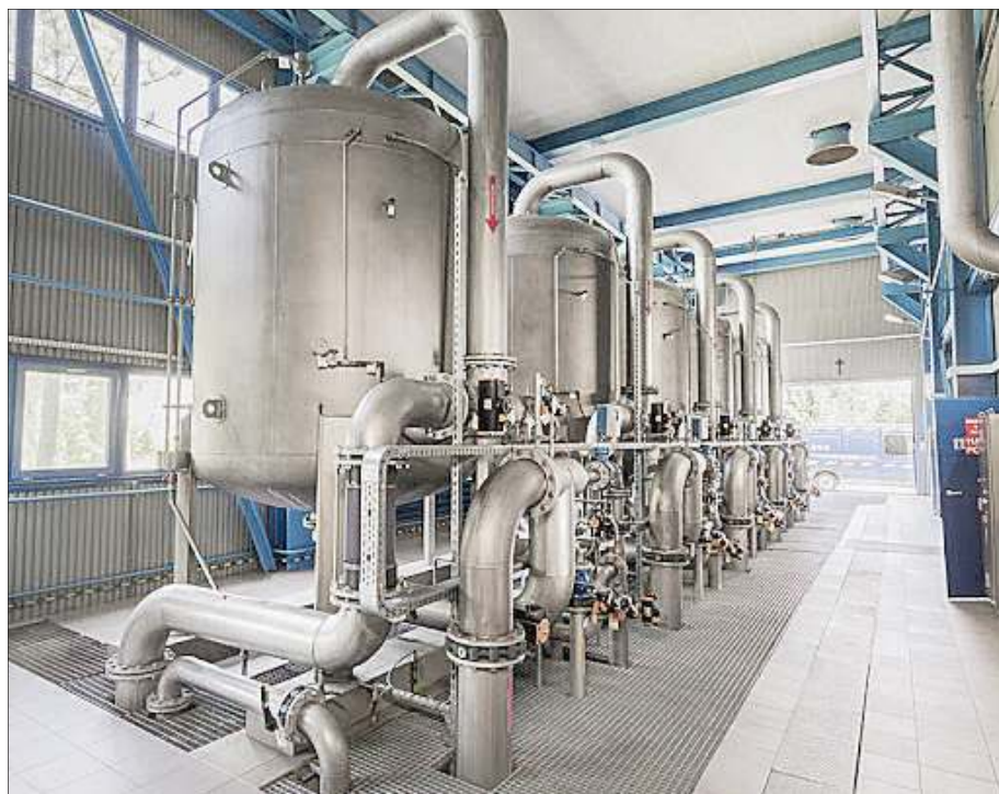
Stacja uzdatniania wody Mikulczyce
