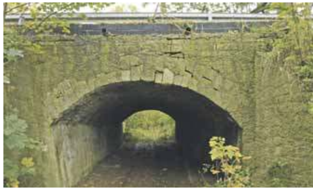
Na konstrukcji mostu rzeczywiście widać spękania
