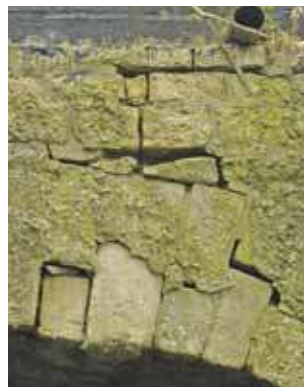
Czy uszkodzone jest tylko lico muru, czy też spękania sięgają głębiej?
