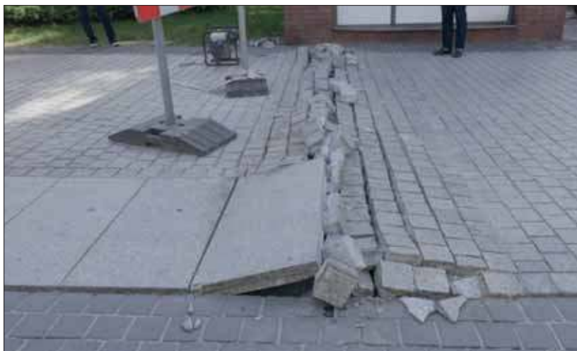
Ekspertyza ma wyjaśnić przyczynę uszkodzenia nawierzchni
