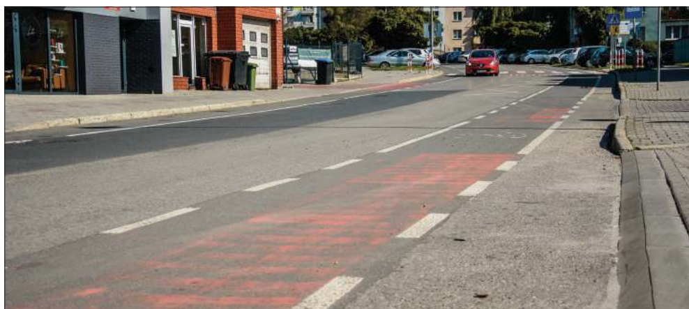
Praktycznie niewidoczna ścieżka rowerowa w ciągu ul. 26 Marca
