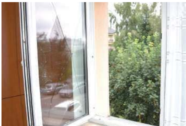
Wybita szyba i uszkodzona ściana - suma spowodowanych przez wandalę strat to 1400 zł
