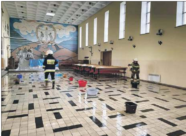
Wiatr zerwał też całkowicie dach z kościoła parafialnego w Siemieniu oraz częściowo z budynku Banku Spółdzielczego w Siemieniu
