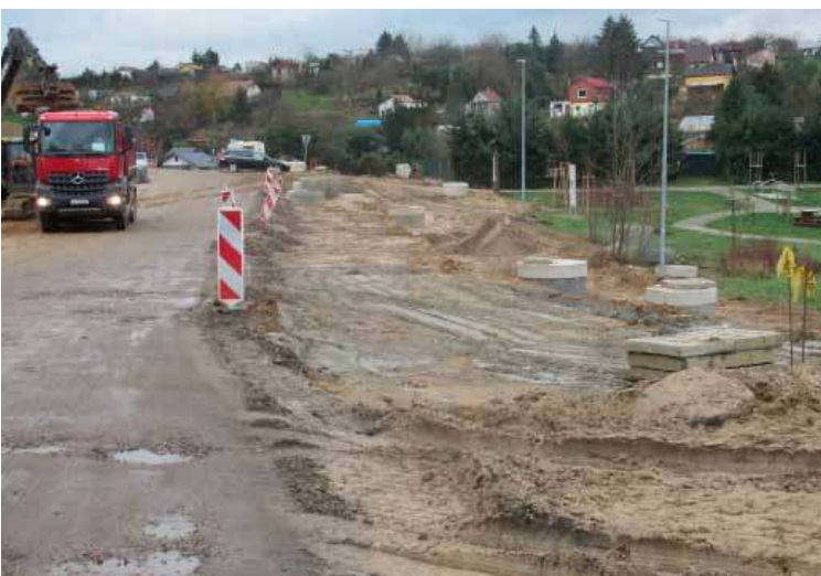
Kanalizacja jest częścią tej inwestycji
