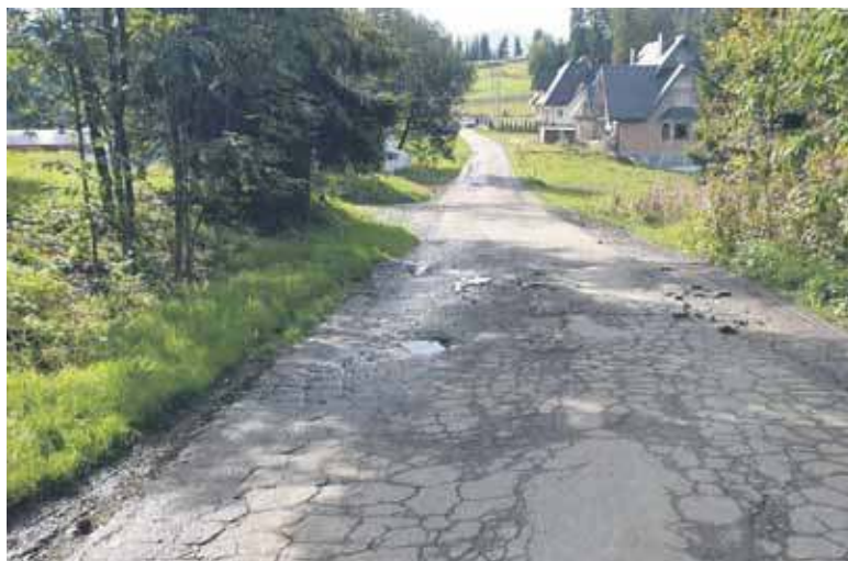
- Czekamy na prawdziwy remont, a nie na „smarkanie” asfaltem w dziury - wołają ludzie w gminie Bukowina Tatrzańska.
