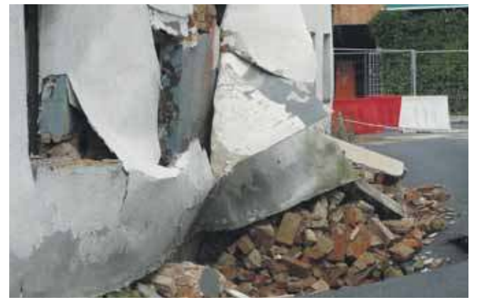
Ściana restauracji, która się zawaliła, jest praktycznie w granicy z miejską drogą, zapadlisko powstało bezpośrednio przy niej
