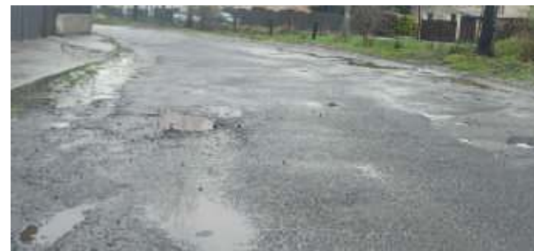
Intensywne opady deszczu dodatkowo wpływają na degradację dróg. Na zdjęciu fragment odcinka w Gościńcach Dolnych
