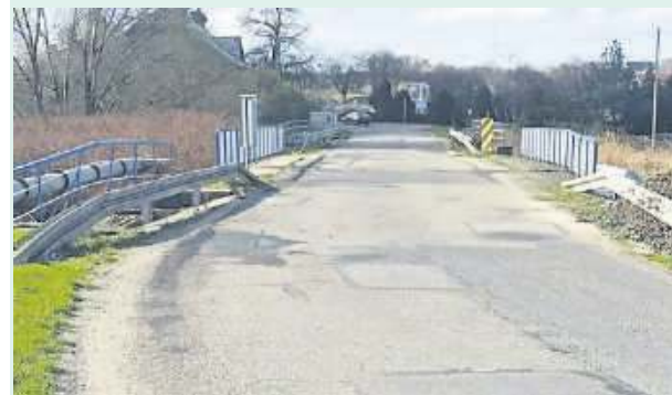
Stan mostów na ulicy Brzegowej w Strzelinie jest bardzo zły, a remont konieczny
