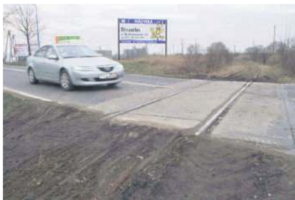
Pozostałości szyn przy wjeździe do Strzelina nie ułatwiają życia kierowcom
