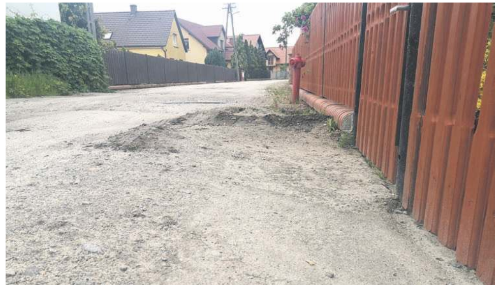
Wyraźnie jest tu niżej, więc woda wlewa się na posesję
