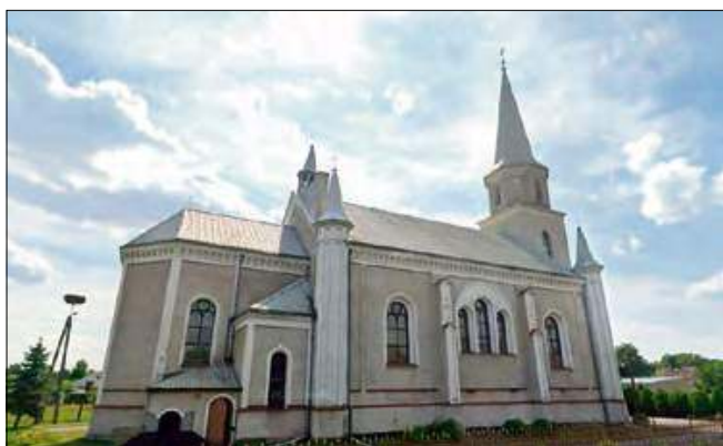
Elewacja kościoła w Obrowcu wciąż czeka na remont.
