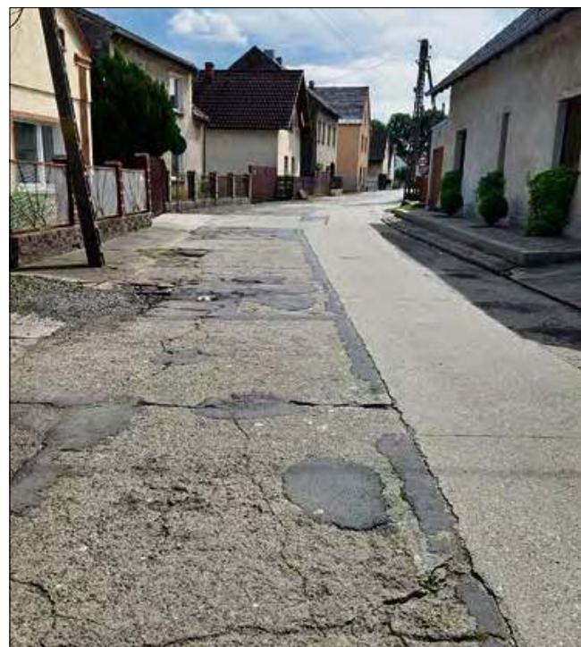
Ulica Osiedle w Strzeleczkach wymaga pilnego remontu.
