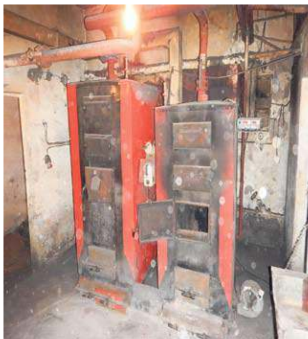
Rys.1. Kotłownia przed modernizacją. Kwiecień 2018 roku
