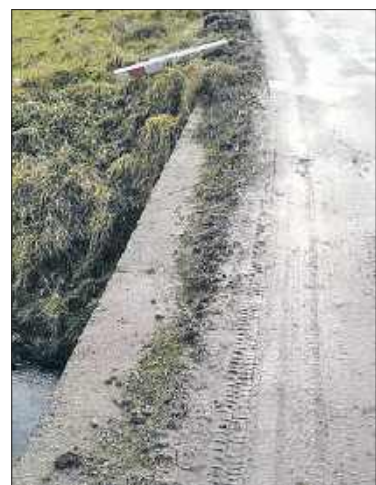
Mostek bez żadnego zabezpieczenia to wstęp do tragedii i dla pojazdów, i dla pieszych, zwłaszcza nocą
