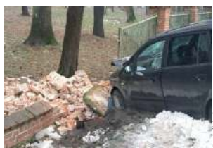
Ogrodzenie zostało mocno uszkodzone
