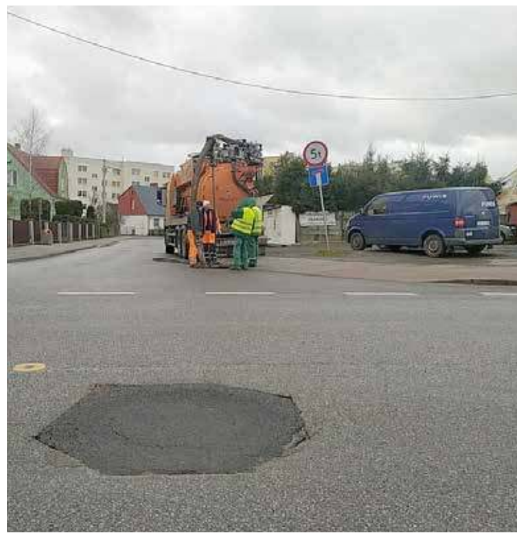
Pracownicy PUWiS tym razem nie mogli skorzystać ze studzienki (na pierwszym planie), gdyż została zalana masą bitumiczną
