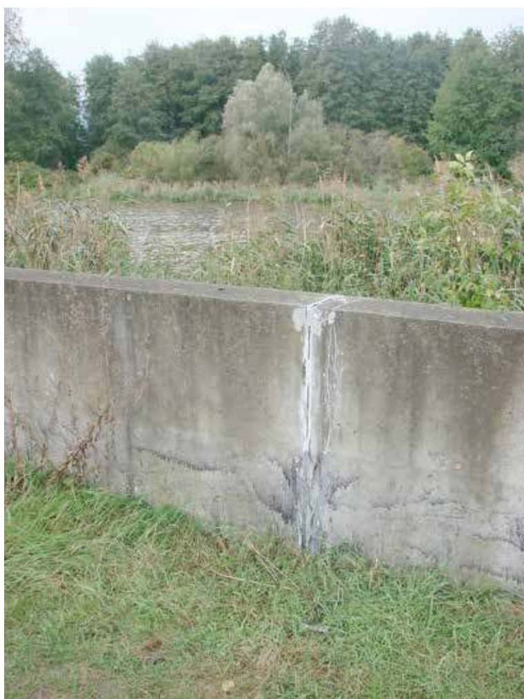
Strażacy uważają, że to pęknięcie może spowodować wlewanie się wody za wał
