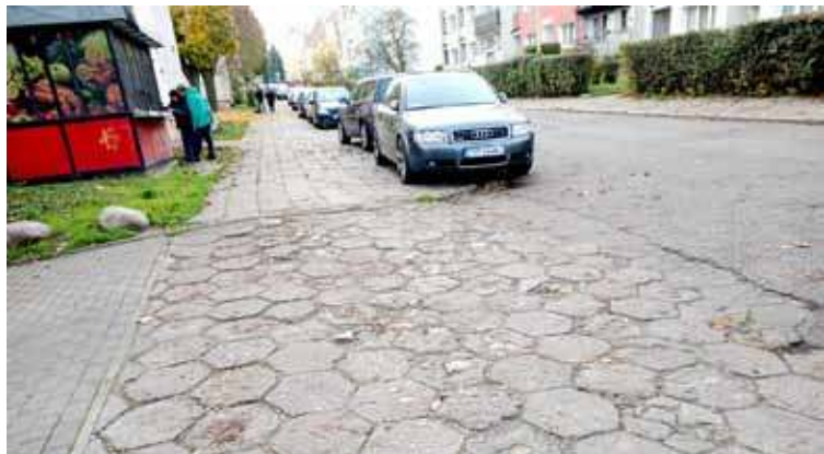
Chodzenie lub pchanie wózka na tym chodniku jest utrudnione z powodu jego stanu
