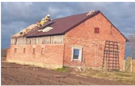
Zniszczony dach na budynku gospodarczym w Jeziorkach.
