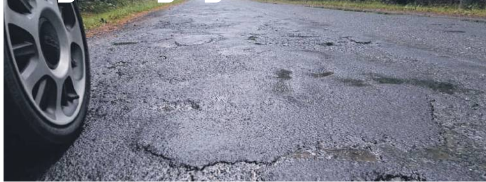
Dziura na dziurze. Ta droga naprawdę zasłużyła sobie na miano najgorszej w powiecie
