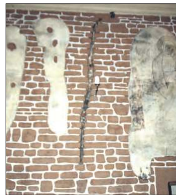
Pęknięcie w murze nie jest przypadkowe
