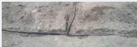
❷ Przed tarasem, na trawniku, biegną rurki rozprowadzające ¾ cala.
