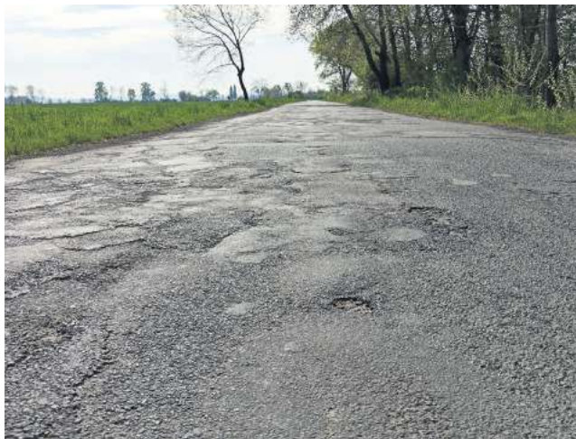
Odcinek był już wielokrotnie łatany. Obecnie wymaga gruntownej przebudowy
