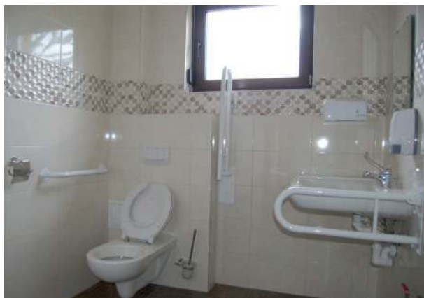
Wszystko wykonano w wysokim standardzie. Toaletę dostosowano w pełni do potrzeb osób niepełnosprawnych
