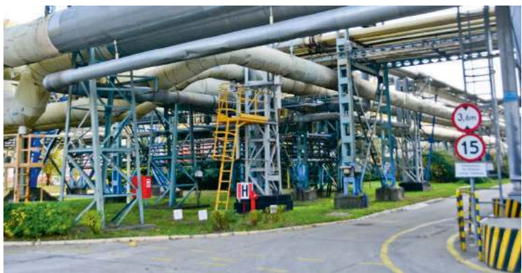
Urządzenia przesyłowe Elektrociepłowni Wrocław | fot. Janusz Wolniak/Gazeta Polska
