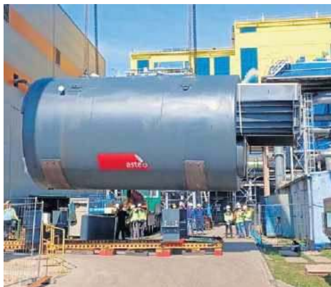
Realizacja całościowego programu modernizacyjnego EG planowana jest na sezon grzewczy 2025/2026
